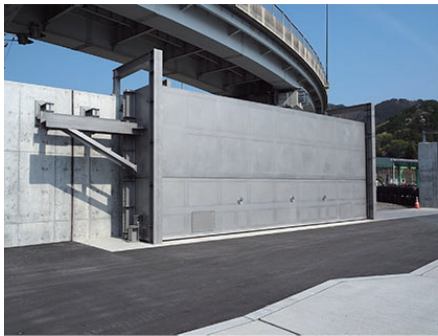
写真1.須賀陸閘12号(高4.2m×長10m)
