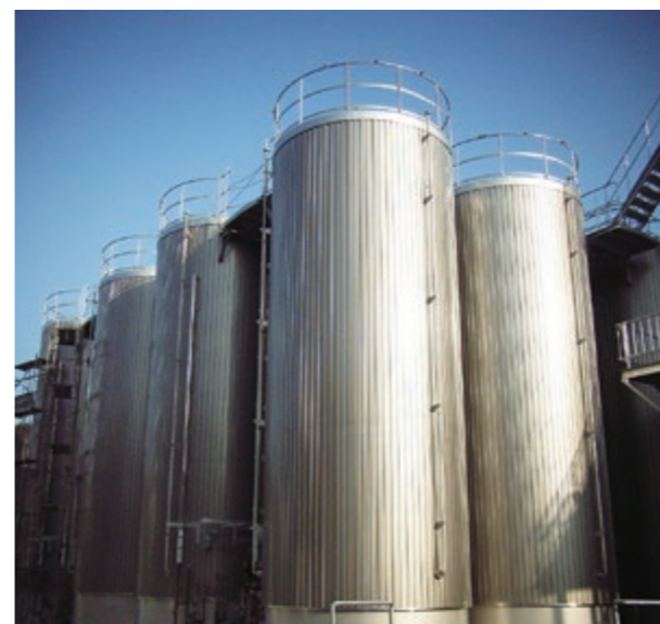
酱油储罐 (NSSC270、SUS312L、S31254) ※上面2张图片的酱油罐式样不同。左边的外壁是SUS304薄板，适用于内部罐。
