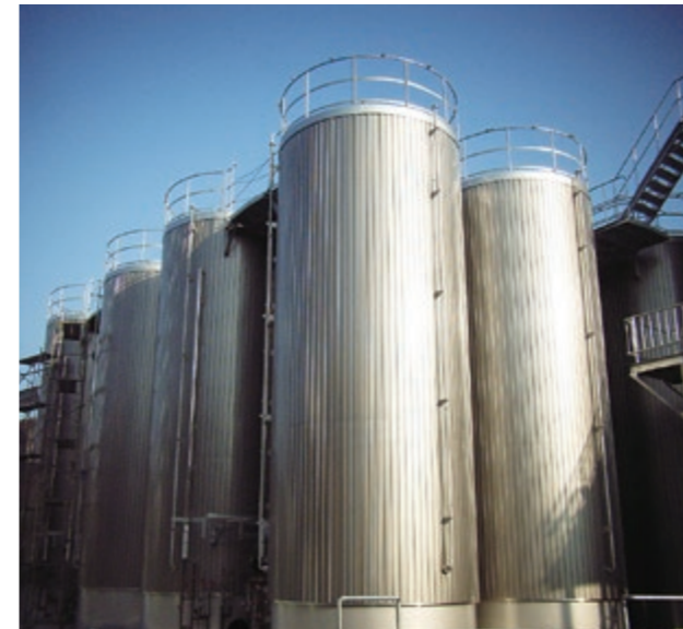
醤油タンク (NSSC270, SUS312L) ※上の写真2枚は型式の異なる醤油タンク。 左側の外壁はSUS304薄板、内部のタンクに適用。
