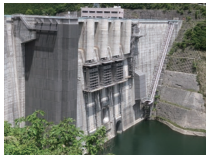
ダム取水塔、高圧ゲート (SUS304, NSSC2120, NSSC2304)
