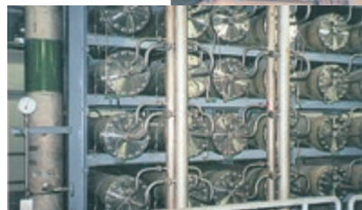
同淡水化プラント内部(RO式海水淡水化装置)
