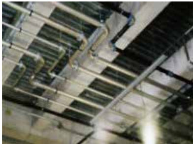
屋内給湯配管
