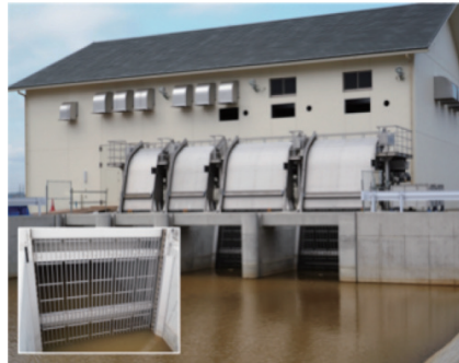
高砂南部排水機場 除塵設備
